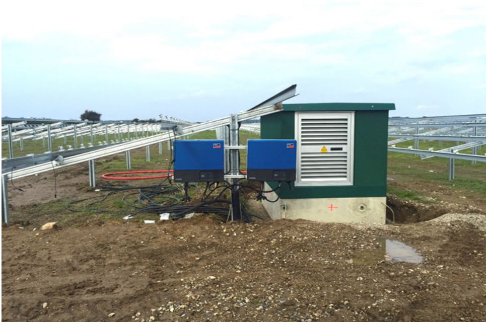
Foto 2. Invertere (blå) og step-up transformere i anlægget
